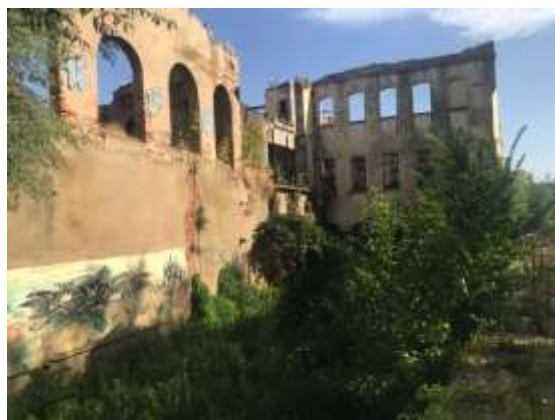
Bâti vétuste jouxtant l'écluse de Sapiacou
