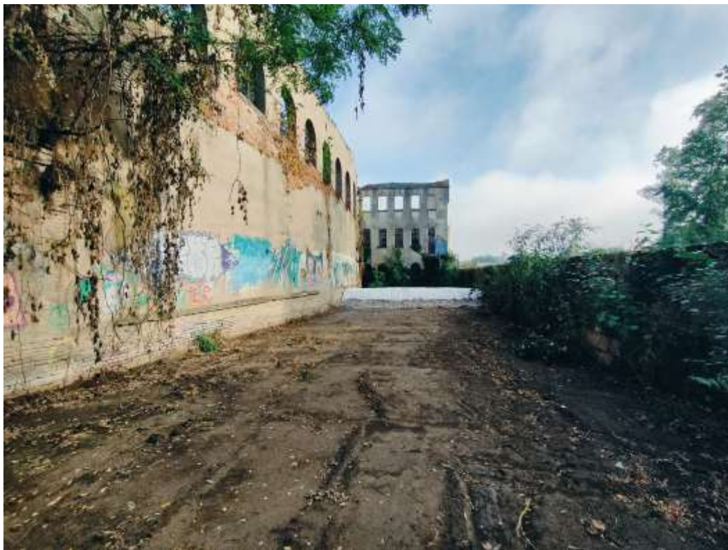
Figure 142 : Photographie bassin de décantation réalisé en 2023 (merlon granulaire filtrant)
