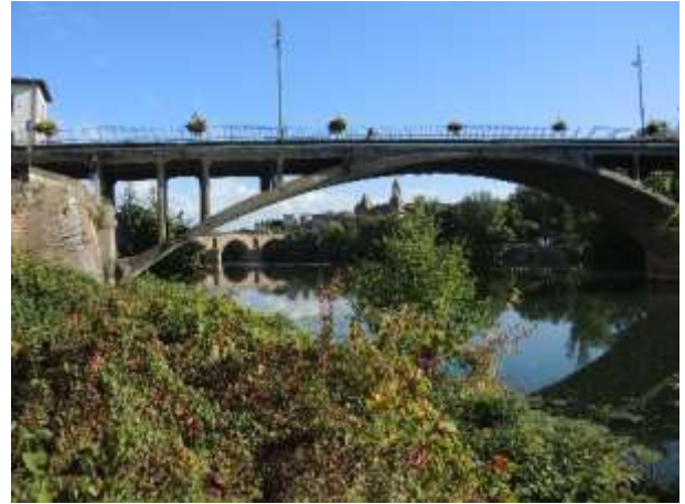
Pont avec mur de la digue (à droite) présentant des disjointements, drains et autres trous potentiellement favorable au gîte de chiroptères communs
