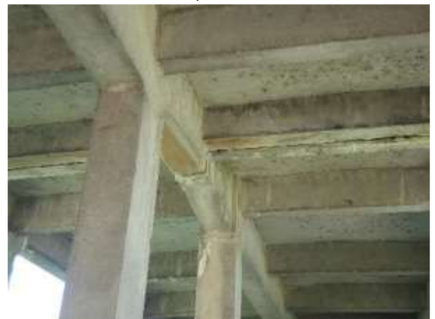
Colonie située dans un disjointement du Pont Neuf
